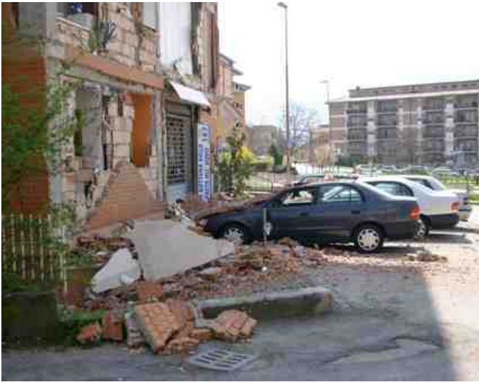
Bei einem Nachbeben hat eine eingestürzte Außenwand geparkte Autos schwer beschädigt.
