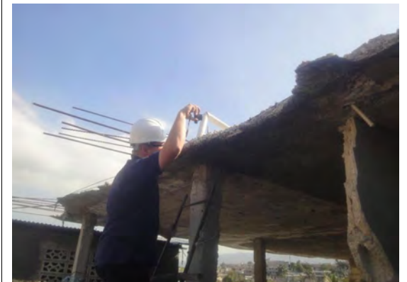
Mit Karsten besichtigte ich unzählige Häuser und Gebäude und lernte viel über erdbebensicheres Bauen. Aus Sicherheitsgründen mussten viele Häuser dringend abgerissen werden.
