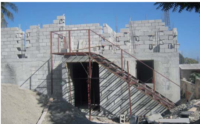
Die Stahlterasse ist der Wermutstropfen. Sie war anders geplant. Als Provisorium für die Bauphase ist sie o.k.
